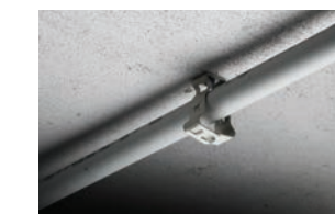
Conduit on concrete
