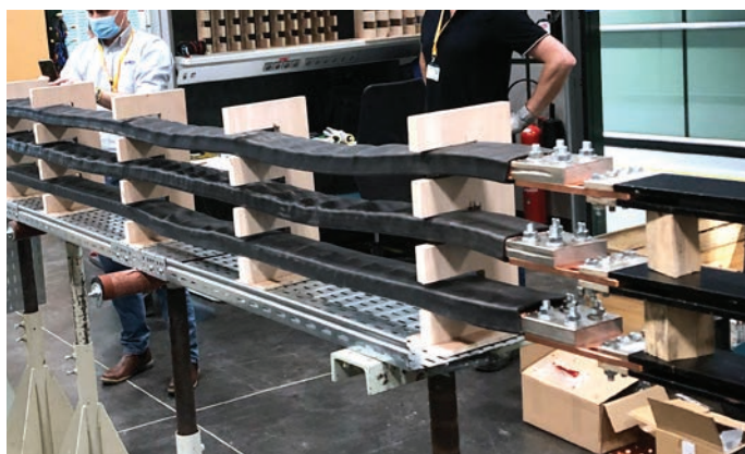
Immagini della sequenza di test di aumento della temperatura e sonda/sensore di temperatura lungo l'installazione
