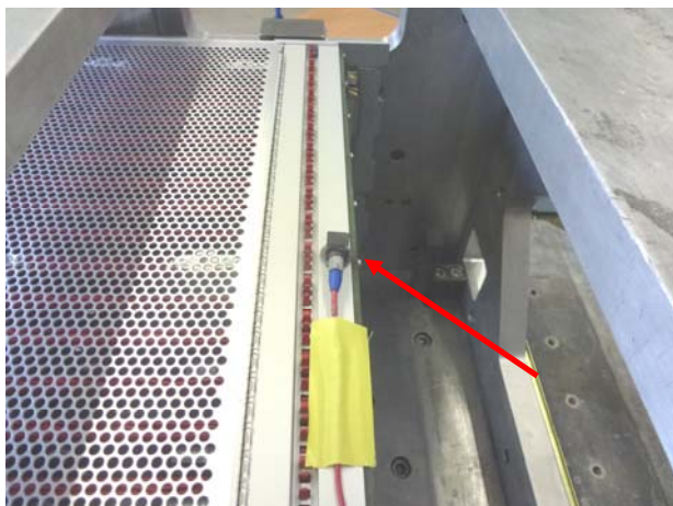
5: Messstelle, Kanal 4 Modulschiene hinten, oben, mittig
