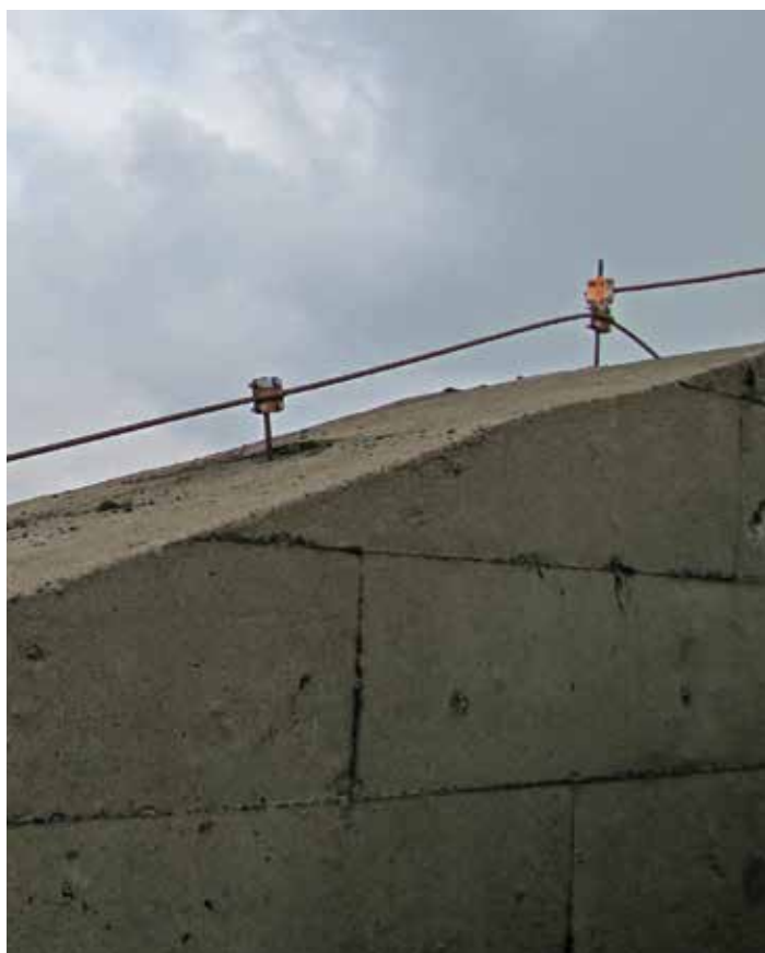
Protection contre la foudre
