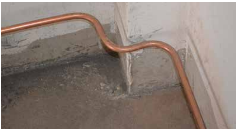
Conducteur de mise à la terre équipotentielle
