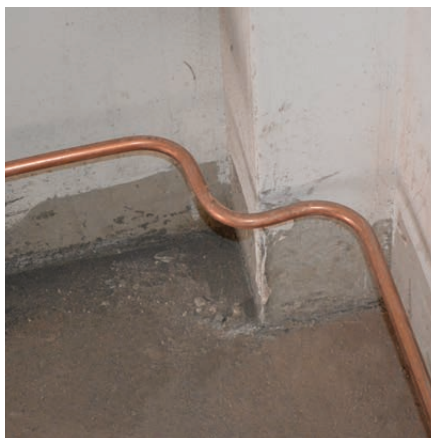
Equipotential grounding conductor
