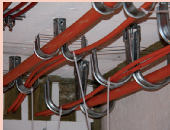
J-Haken und Kabel in Brandkammer vor Brandversuch
