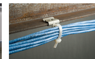
Kabels vanaf balken
