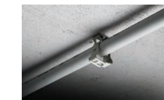
Conduit on concrete
