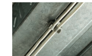
Cables & conduits from metal deck
