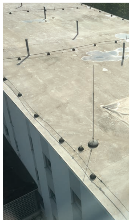
Eine einfache Blitzschutzanlage vor der Verbreitung von dachmontierten Geräten
