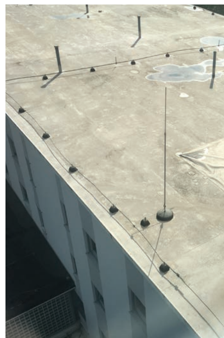
Sistema de protección contra descargas atmosféricas sencillo antes de la multiplicación de equipo en la azotea
