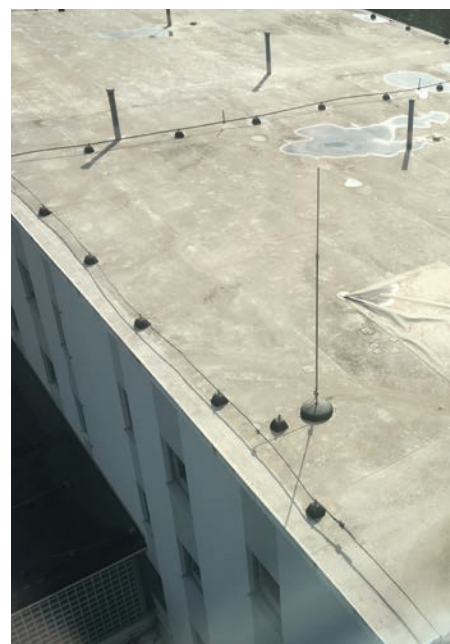
Système de protection contre la foudre avant prolifération des équipements de toiture
